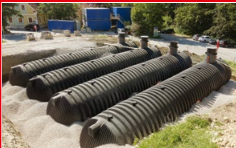
Abbildung zeigt 4 x 56.000 Liter Löschwasserbehälter Carat XXL
