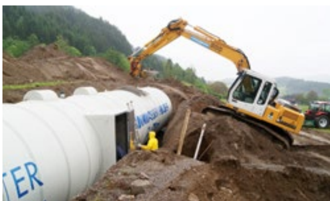
150.000 L Speicher mit mittiger Schieberkammer
